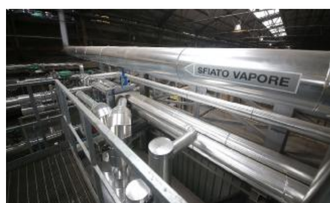
Un impianto per il recupero di calore collegato al teleriscaldamento
